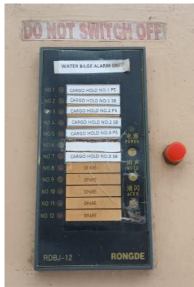
Gambar 6. Kondisi Panel Alarm Bilge saat Dilakukan Pengecekan Operasional Oleh Perwira Kapal.
