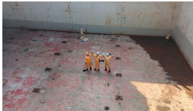
Gambar 2. Kondisi Dasar Palka yang Masih Terlihat Lembap dan Terdapat Sisa Genangan Air pada Beberapa Sudut Ruang Muat.
