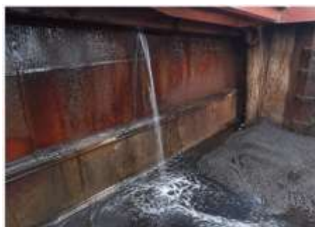
Gambar 3. Kondisi Kebocoran Palka.
