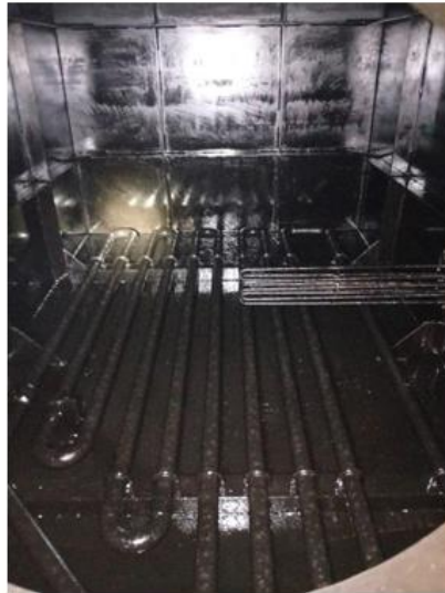
Gambar 1. Settling tank sebelum Dibersihkan.
